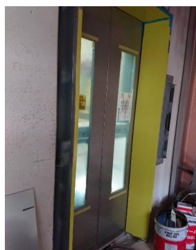
エレベーター
